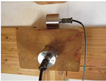
1층 거실 센서 설치
