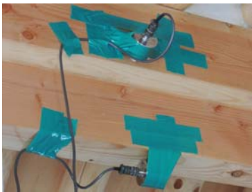
2층 거실 센서 설치
